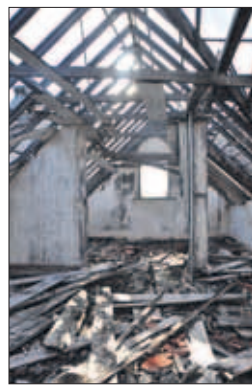
Verval op de bovenverdieping.
