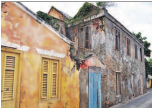
Dit fraaie vervallen gebouw (rechts) in de Gasthuisstraat stond er niet lang geleden nog. Nu is het een open plek.
