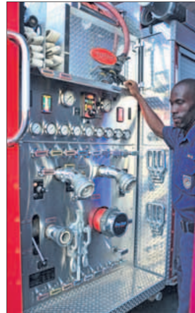
Pines bij meters en afsluiters aan de zijkant van de wagen.
