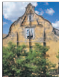
Gestutte gevels van een eens schitterend gebouw.
